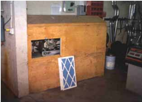
Ce compresseur a été placé dans une boîte sur mesure. La ventilation est assurée par une ouverture dans le mur extérieur.
