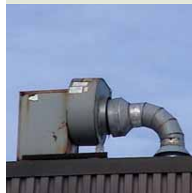
Comme il fonctionne en tout temps, le ventilateur d'aspiration des gaz d'échappement est dérangeant. En le plaçant sur le toit, on élimine cette source de bruit.
