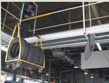
La passerelle et le palan pour monter le chariot à pneus est un moyen peu encombrant de faciliter la manutention des pneus entre le niveau service au sol et le niveau entrepôt quelques mètres plus haut.
