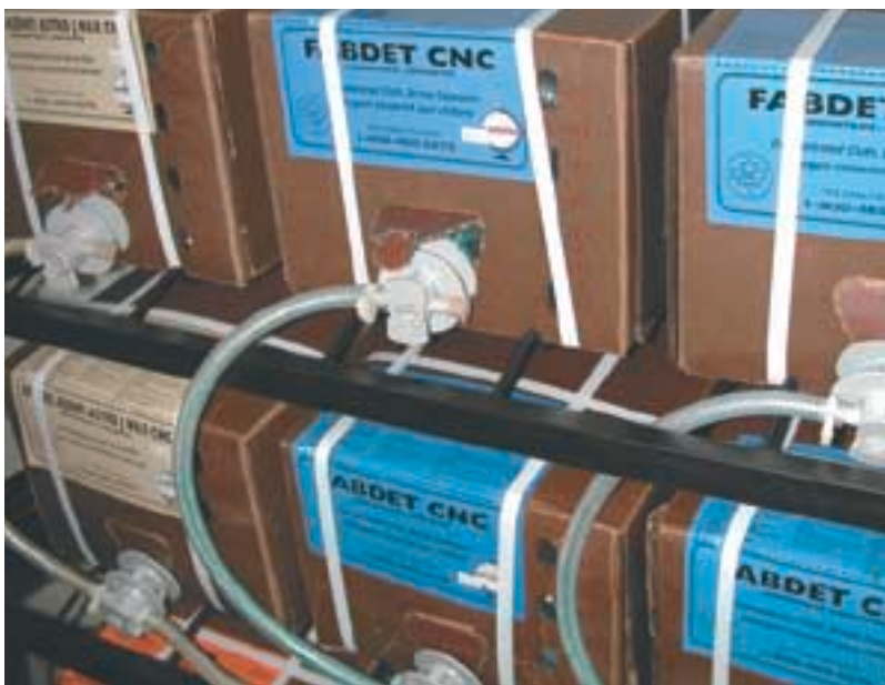
Lorsque possible, on privilégie une installation comme celle-ci où les produits sont mélangés automatiquement. On évite ainsi tout contact direct avec le produit.
